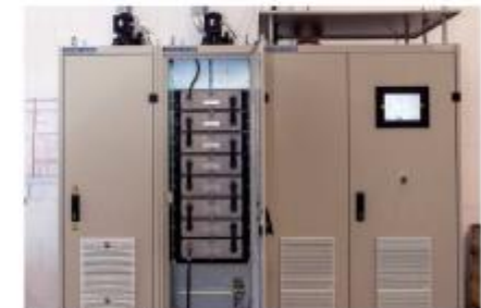
Batterie Bank 28 kWh
